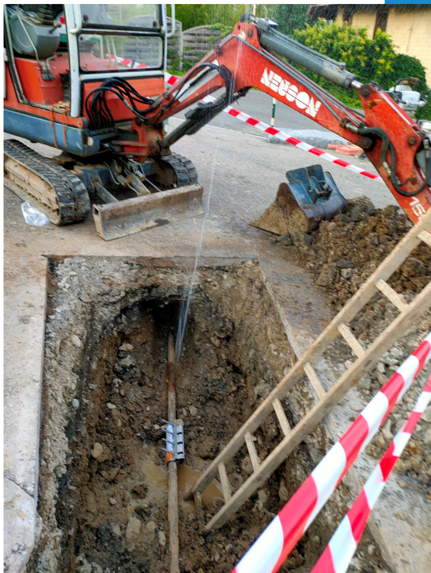
Defekte Zuleitung Langmatt, Oktober 2023
