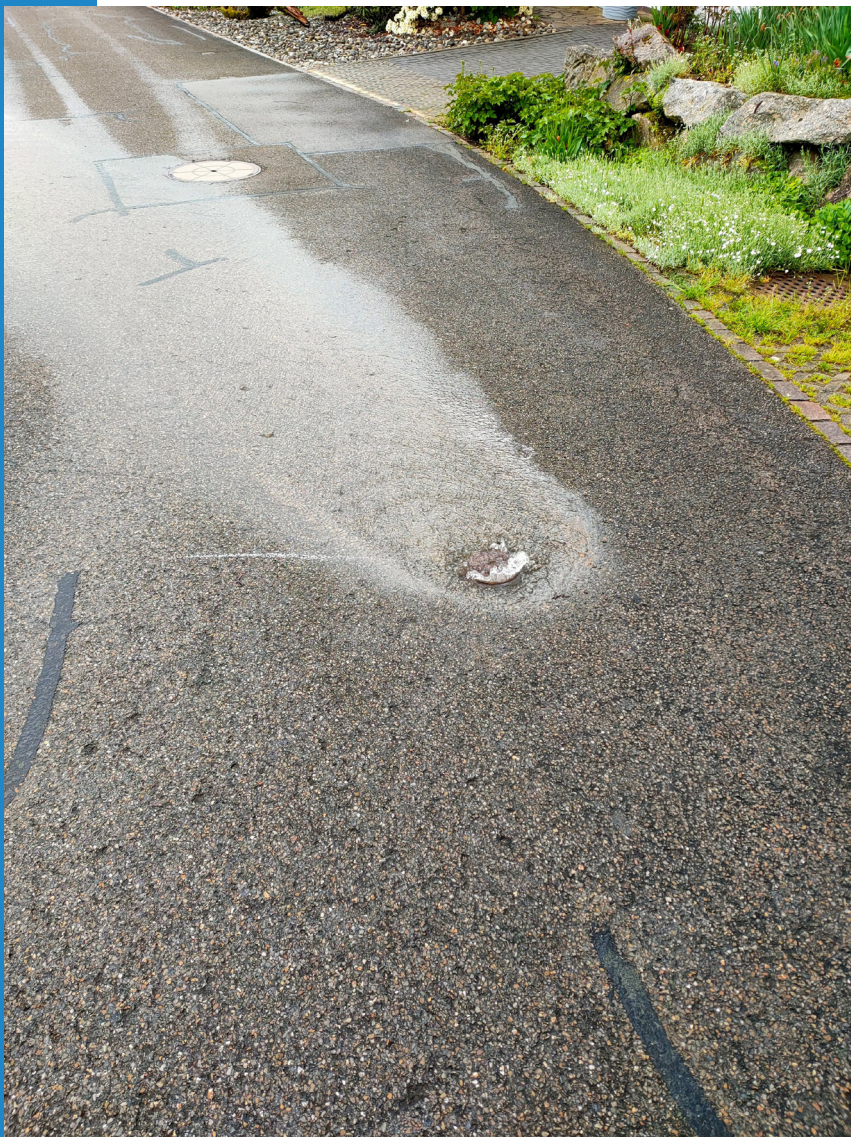
Defekter Wasserschieber, Hofmatt, Mai 2023
